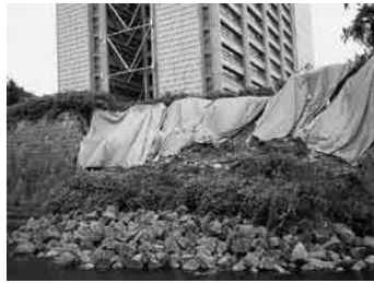
静岡沖地震(平成21年8月11日発生、最大震度6弱)で崩壊した静岡県庁の石垣(三重県撮影)
